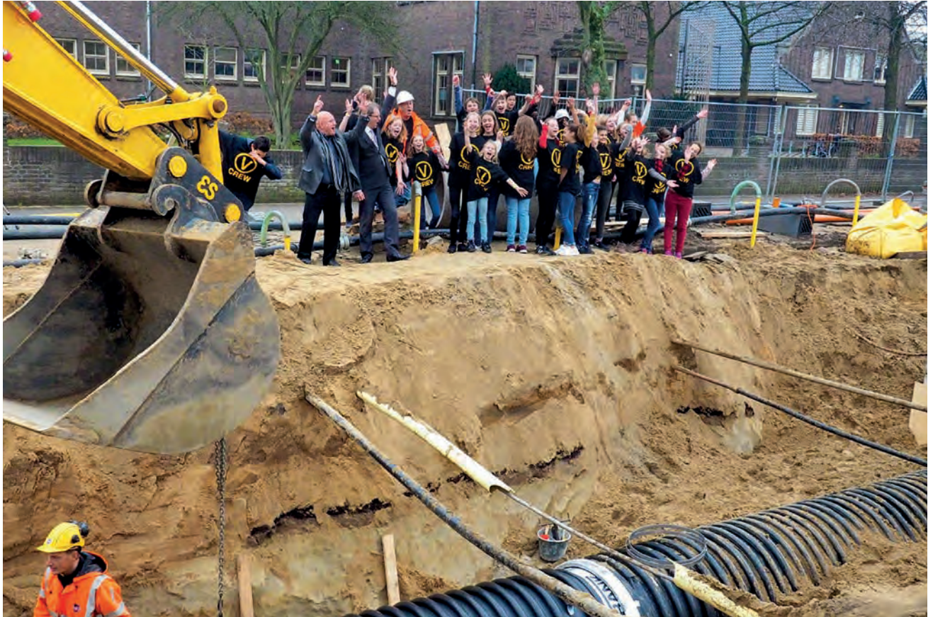
Floor Bal (links) en Marc Boelsma (rector Vellesan College) leggen samen met leerlingen van de school de eerste riothermiebuis. De school zal als eerste in Nederland verwarmd en gekoeld gaan worden met deze techniek.
